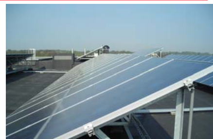
polykristallijne PV-panelen op het plat dak
